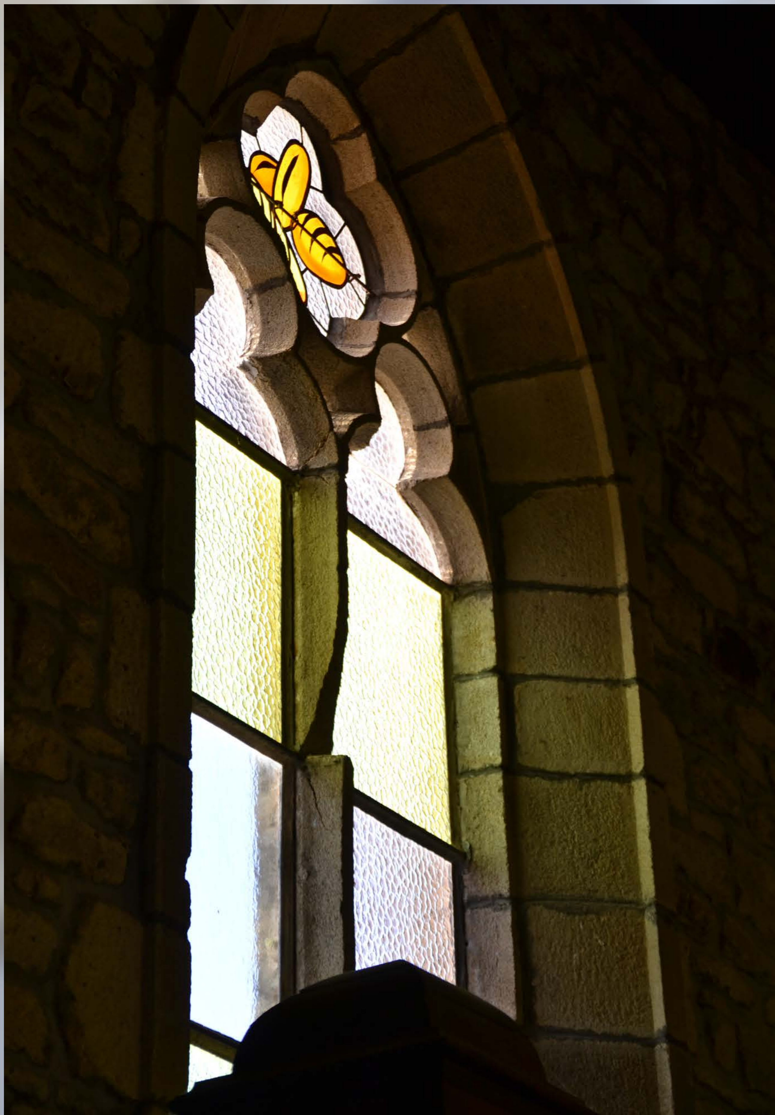
Altérations constatées dans les pierres
